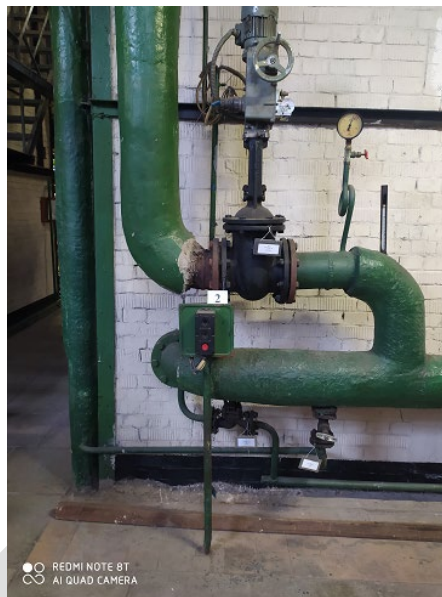
2 Котел водогрейный ТВГ-8м
