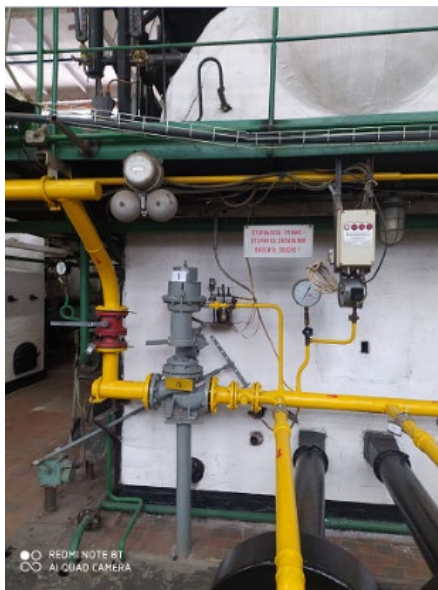
1. Паровой котел ДКВр 2,5-13ГМ
