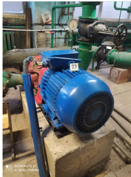
22 Насос 1Д 200-90 с дв.90кВт
